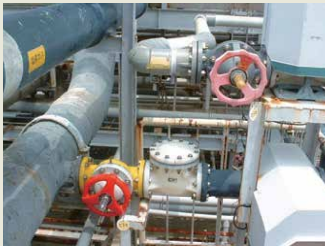
⌘ Valvola di non ritorno in PVDF installata orizzontalmente presso un impianto chimico funzionante da oltre 20 anni.
