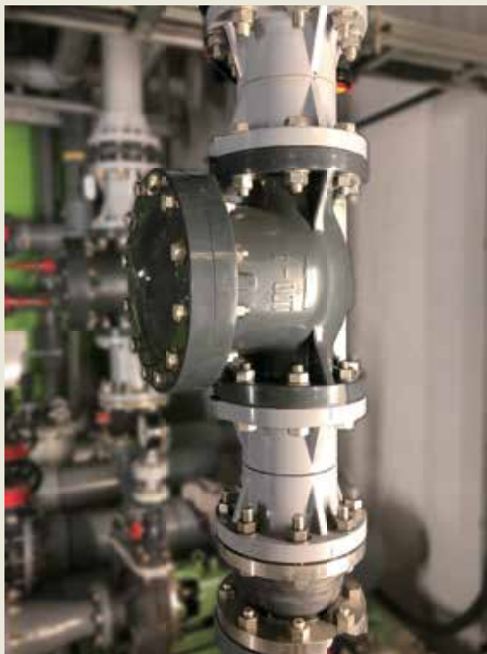
⌘ Valvola di non ritorno a piattello installata verticalmente in un acquario in Giappone.
